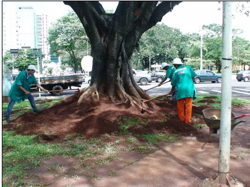
FOTO 03 – Solicitamos para averiguação a retirada do material (terra) depositado na base da árvore;
