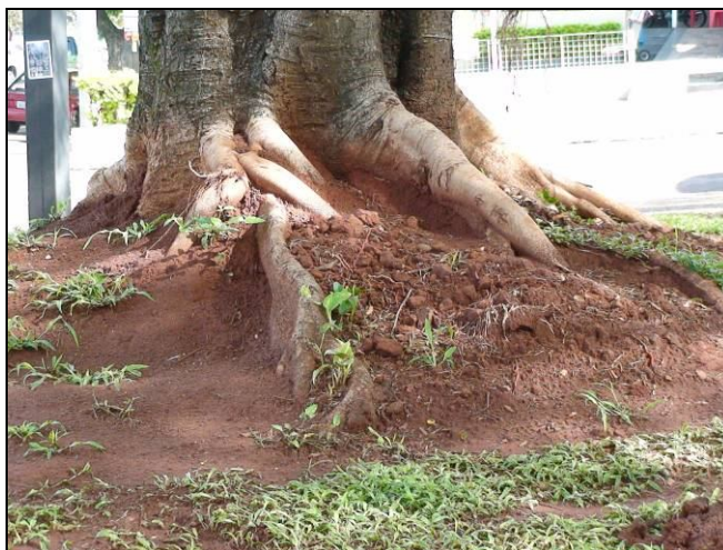
FOTO 01 – Situação em que encontramos a árvore localizada no cruzamento da Avenida Afonso Pena e Rua Padre João Cripa;
